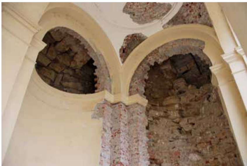
Die Schäden sind unübersehbar: Eingangshalle des Belvedere. Foto: © SPSG / Förderverein Pfingstberg
